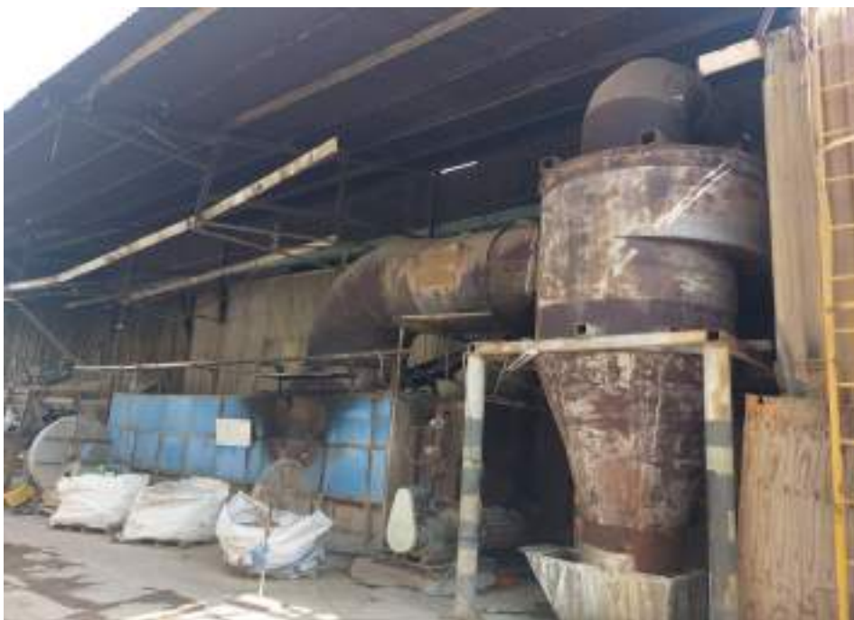
Hình 3.10: Hình ảnh hệ thống xử lý bụi, khí thải
