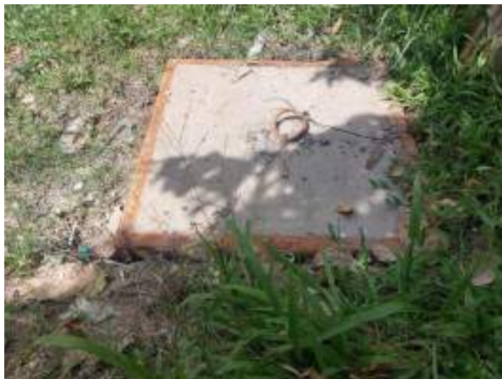
Hình 3.3: Hồ ga đầu nối nước thải của cơ sở với KCN Nhơn Trạch II – Nhơn Phú
