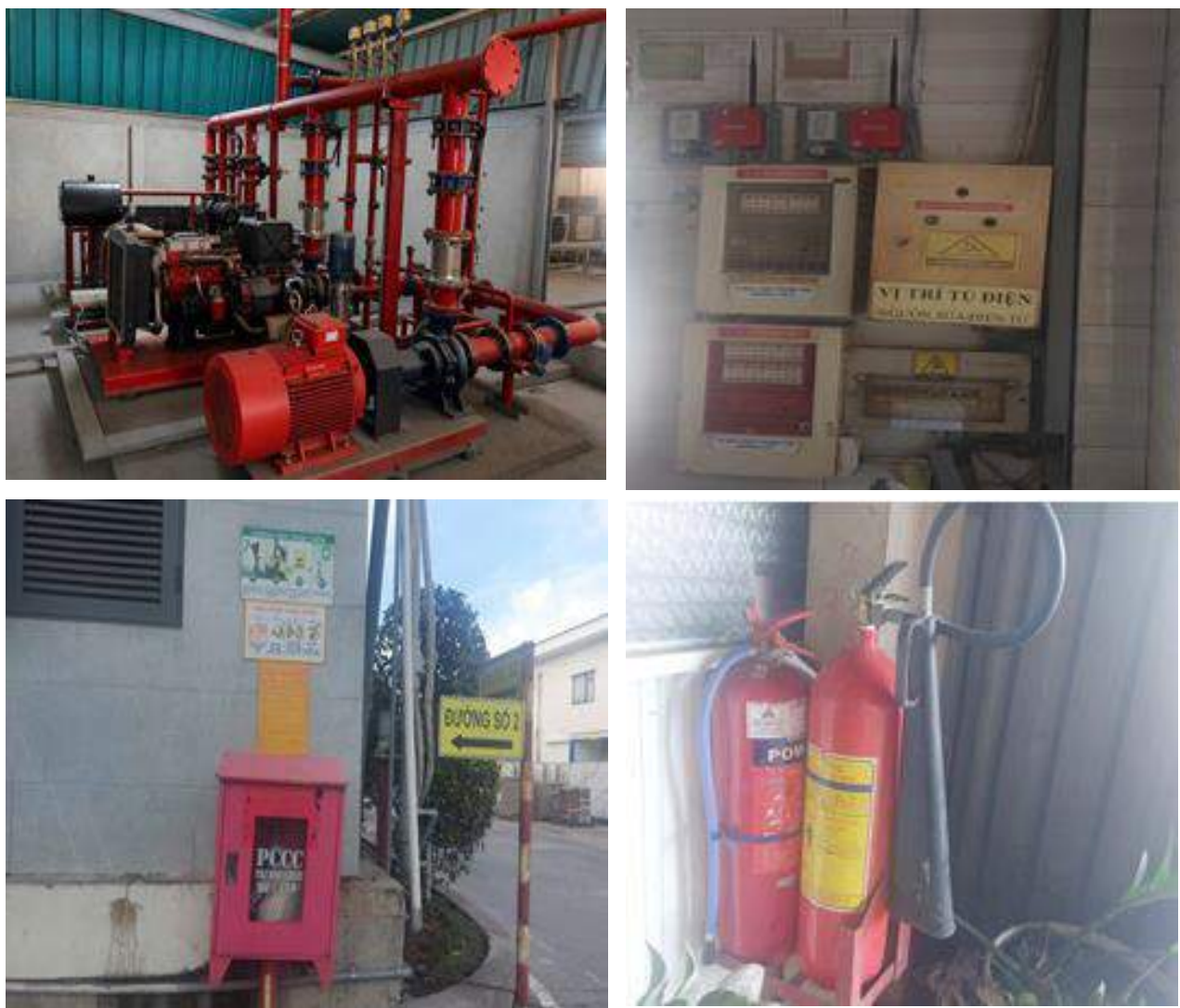
Hình 3.13: Hình ảnh trang thiết bị PCCC
