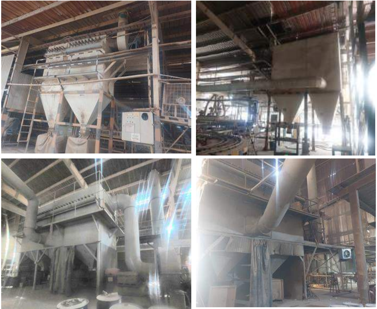
Hình 3.12: Hình ảnh hệ thống xử lý bụi, khí thải
