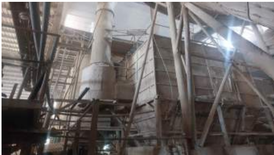
Hình 3.8: Hình ảnh hệ thống xử lý khí thải lò đốt tháp sấy phun
